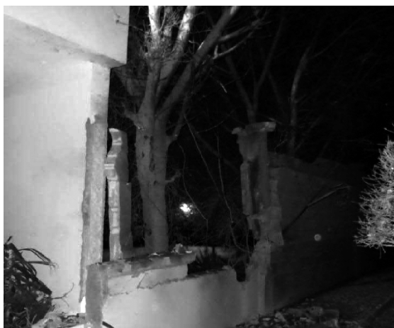
Imagen 2: Muros exteriores del Consulado de Benghazi.
